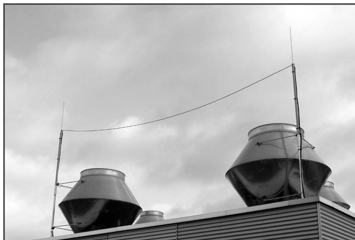
Fig 6a: ventilatiesysteem met elektrisch gescheiden vanginrichting en kabeloverspanning
